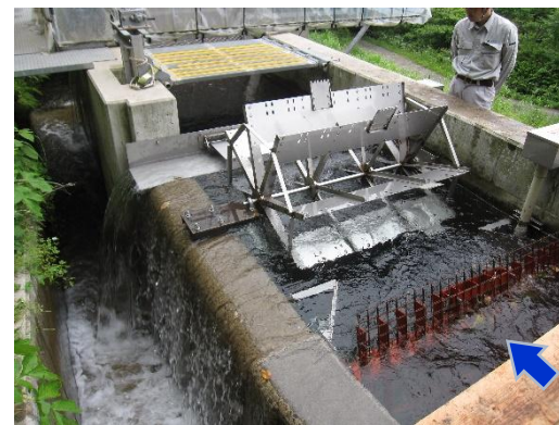
実証運転状況
