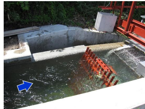
実証運転状況
