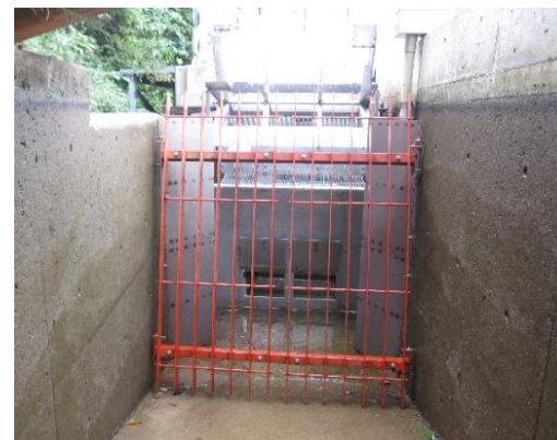
除塵機の手前に粗目スクリーン
