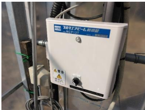
散水設備（制御盤）
