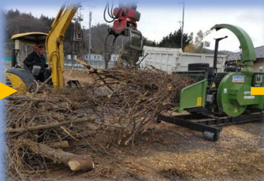
現地破碎状況
