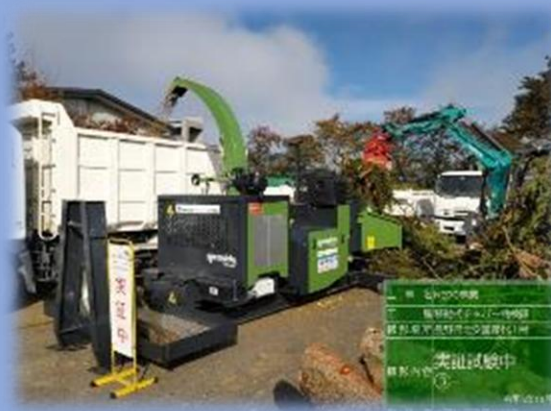
現地破碎状況
