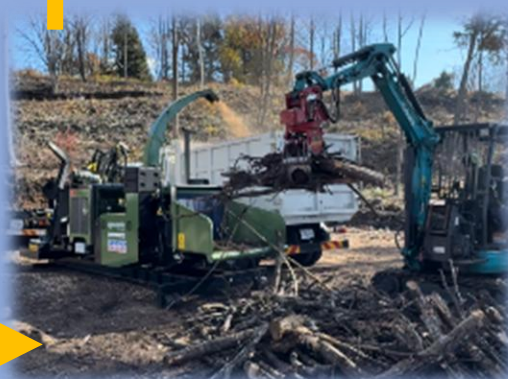
現地破碎状況
