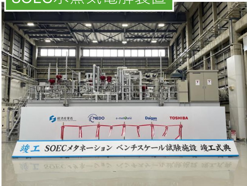
SOEC水蒸気電解装置
