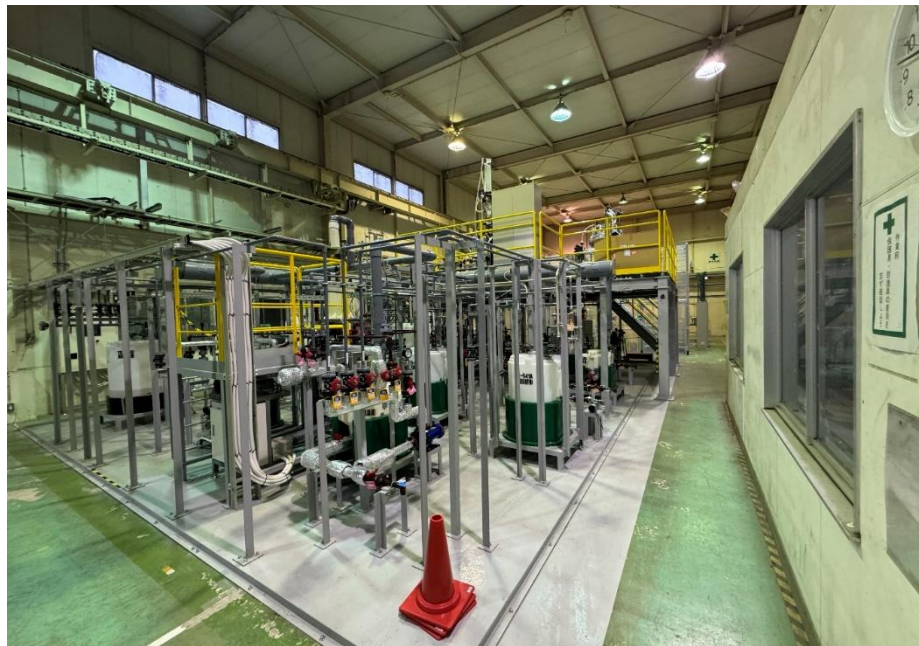
炭素分離・水素製造エリア
