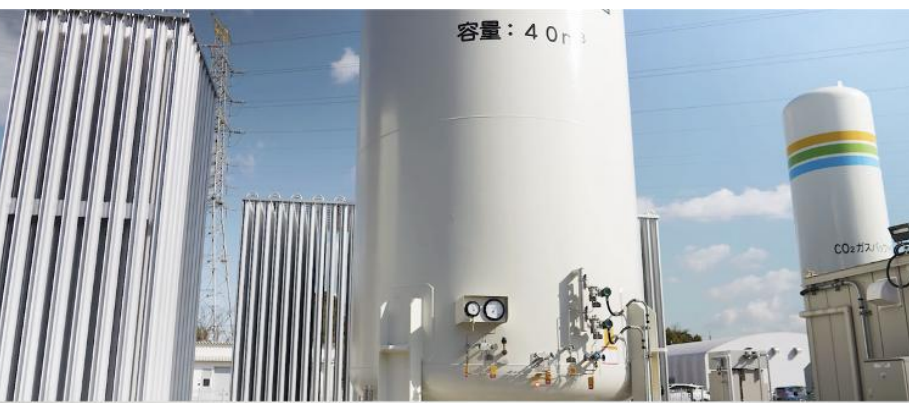
CO 2 供給設備
